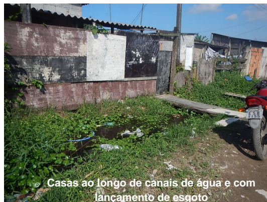
Beco da Paz – Habitação tipo palafita que necessita vistoria e manutenção
